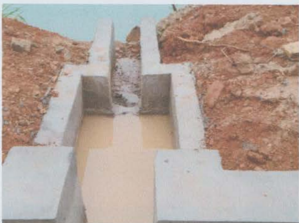
排水沟及沉砂池
